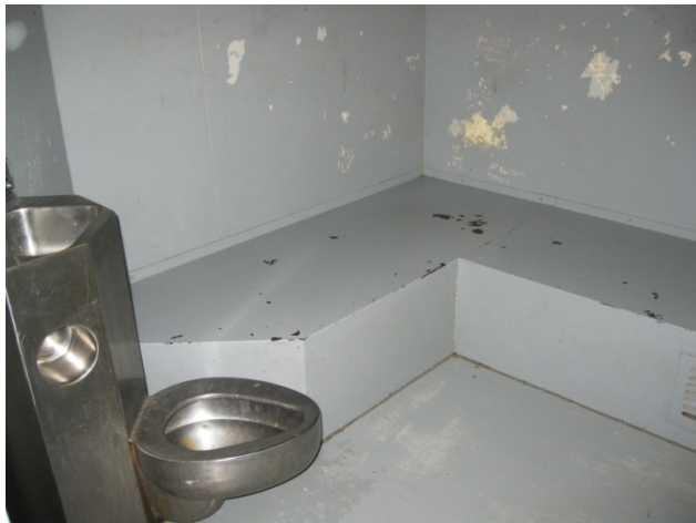
Illustration 7. Banquette et installations sanitaires dans les cellules.
